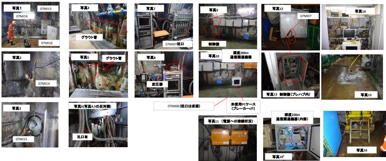
【別図 5.21】 深度 200m における撤去対象の観測機器
